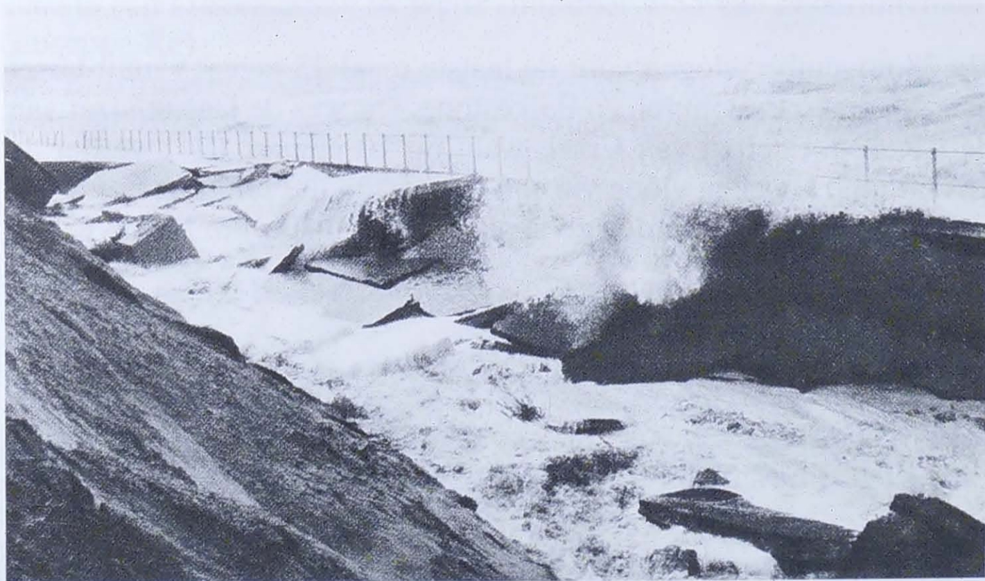
Golven vernielden de dijk bij de 'Lekkerbek' in Knokke.
