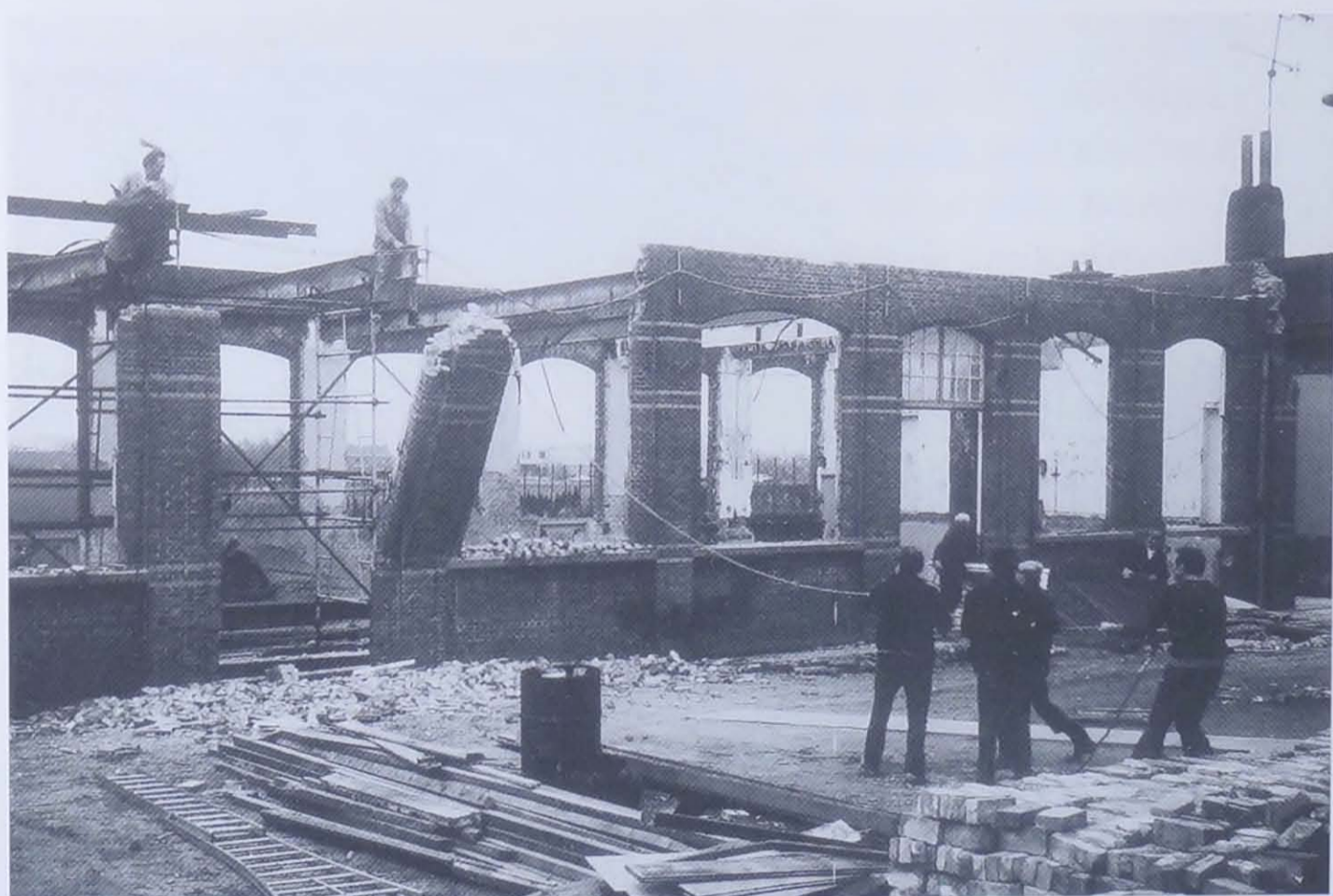
August Wynsberghe helpt trekken. Marcel Ledeganck en Lode Vanderbeken staan op de steigers.
