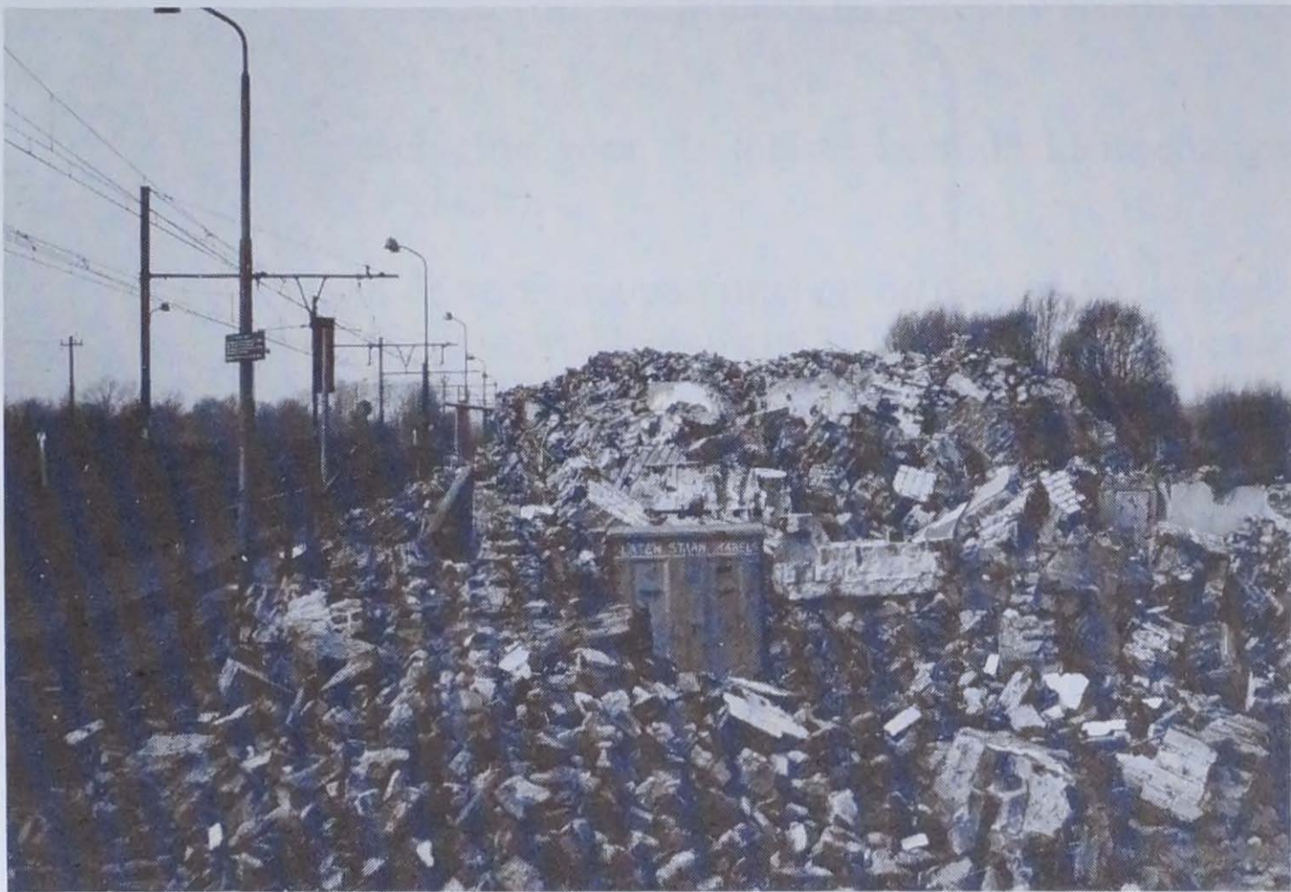
Het gesloopte stationsgebouw, met tussen het puin de overeind gebleven electriciteitskast, waarop voor de slopers de verwittiging "LATEN STAAN KABELS" aangebracht was. (Verz. E. Van Nevel, Bellem.)
